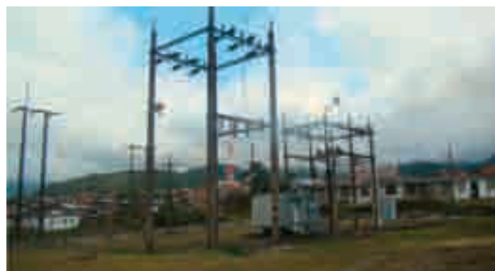
Subestación Pueblo Rico antes de las obras de modernización
