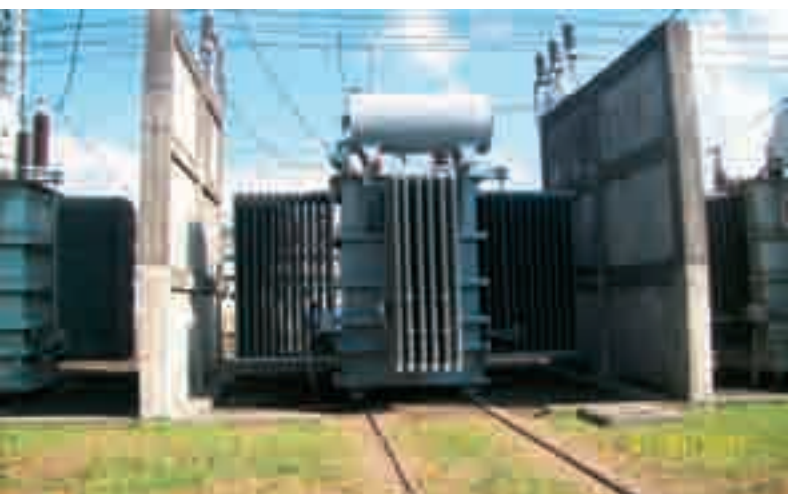
Unidad de 20 MVA, 115/33 kV de la Subestación La Rosa
