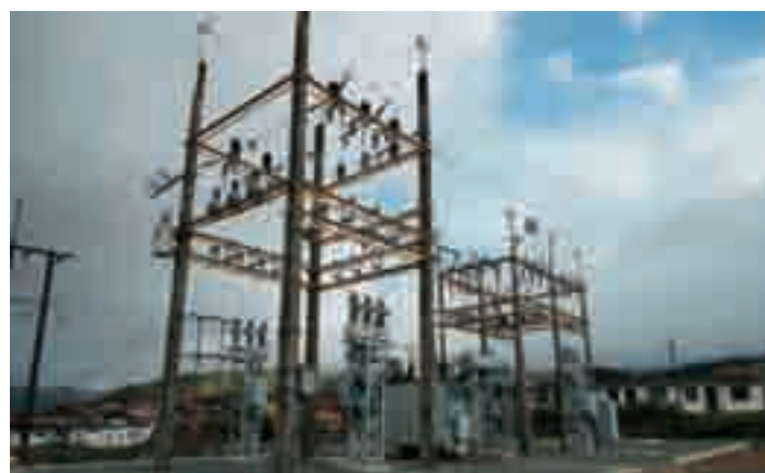
Subestación Pueblo Rico después de las obras de modernización
